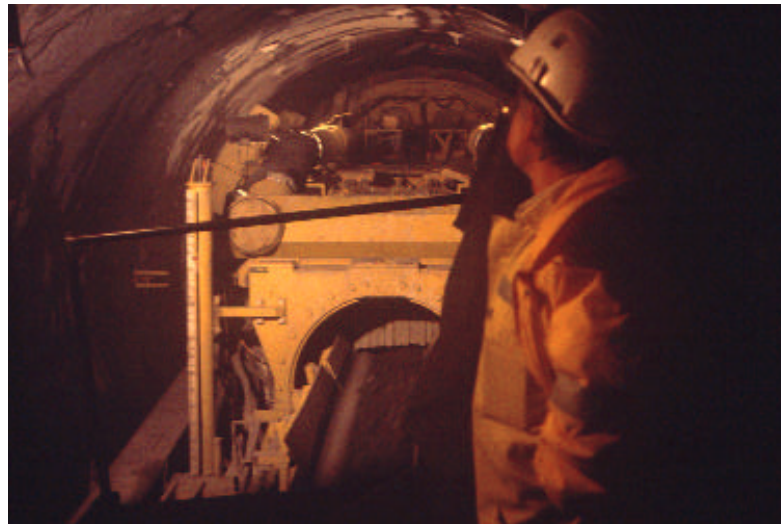
Les Espagnols ont été les premiers à creuser des galeries de communication entre le tunnel ferroviaire et tunnel routier pour les besoins du chantier (Photo BAP)
